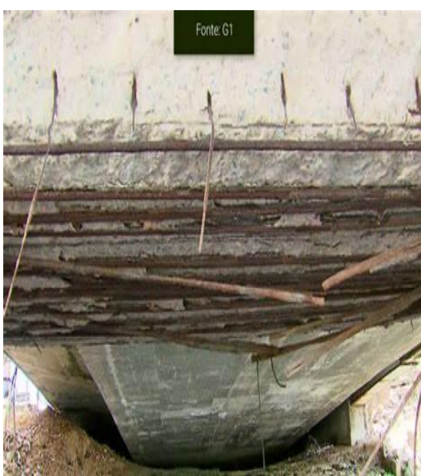
Figura 1: Corrosão nas armaduras de concreto (Fonte: PORTAL G1)
