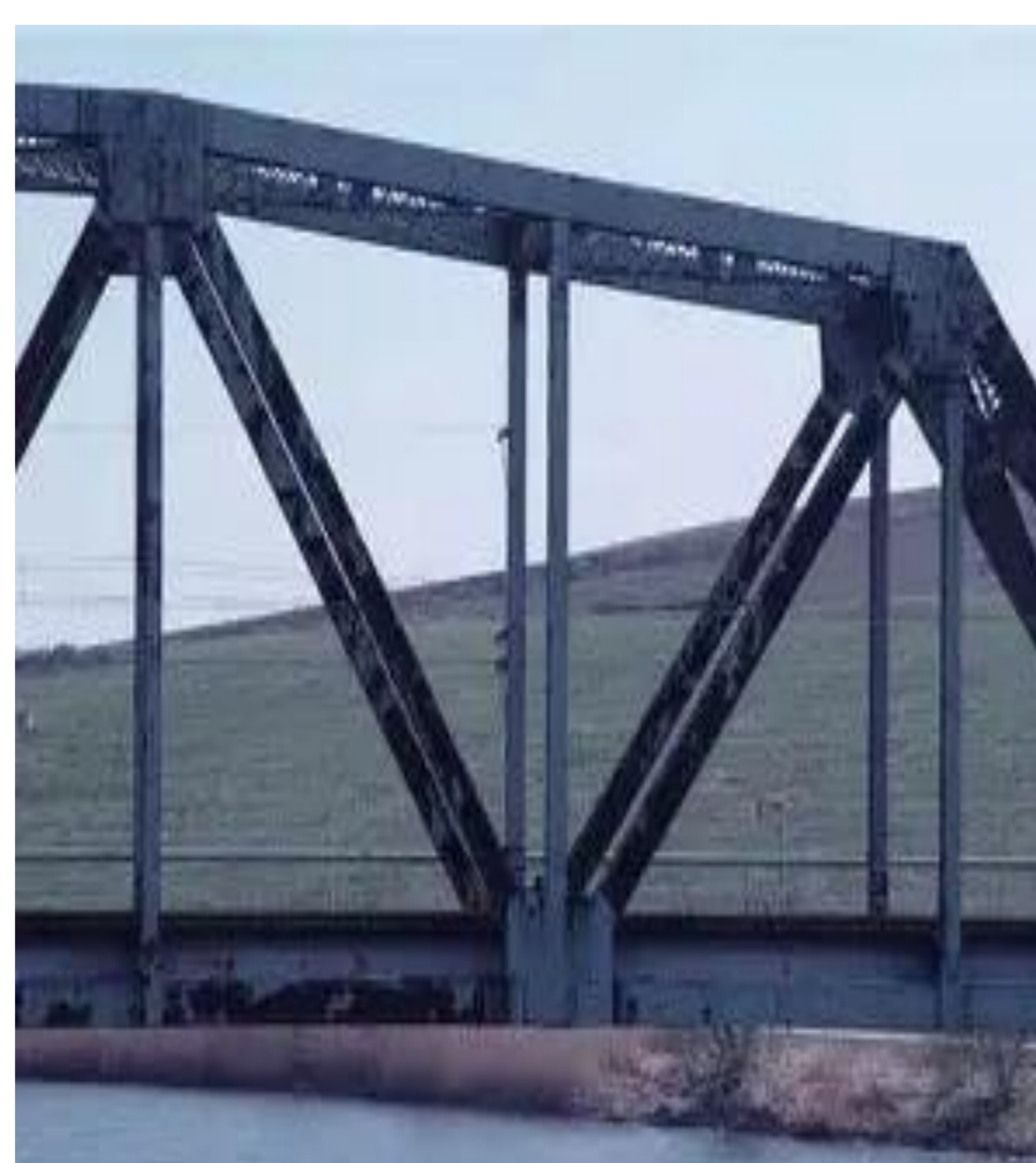
Figura 2: Estrutura metálica com sinais de corrosão (Fonte: PORTAL G1)
