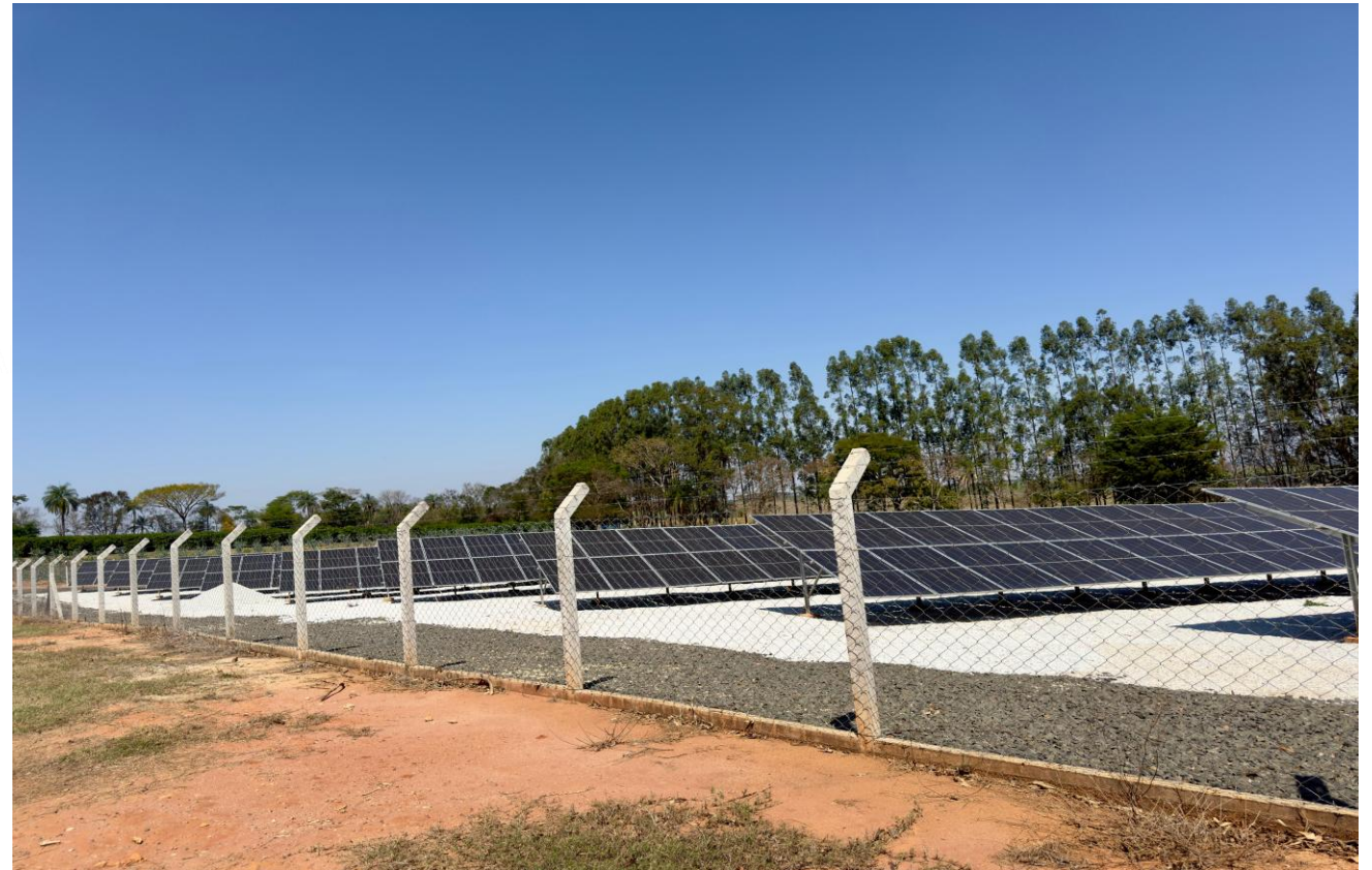
PLACAS DE ENERGIA FOTOVOLTÁICA
