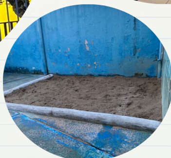
TANQUE DE AREIA
