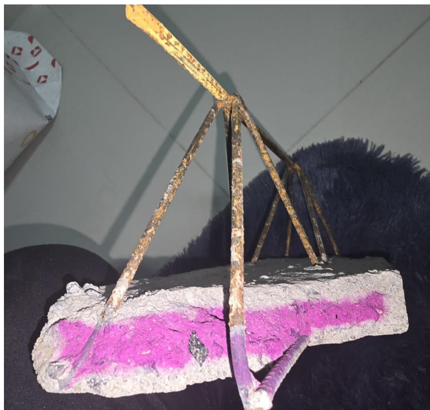
Foto 3 – Amostra de concreto após a aplicação da fenolftaleína
